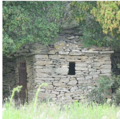
Laure Minervois : capitelle à plan carré et couverture de lauze de pierres calcaires
