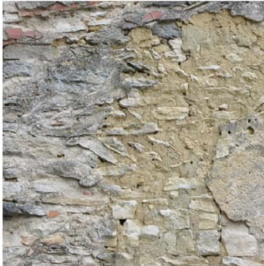
Moussoulens mur mitoyen faisant apparaître mélange de terre crue et de pierre calcaire
