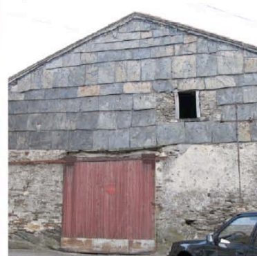
La Tourette : le bardage cet édifice situé sur la place entre dans la composition de la façade tout en protégeant du nord ouest.
