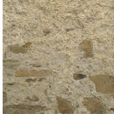
Labastide Esparbairènegue : enduit à fleur résultant du lessivage de l'enduit par les intempéries.
