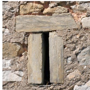
Trassanel : ventilation pour une grange
