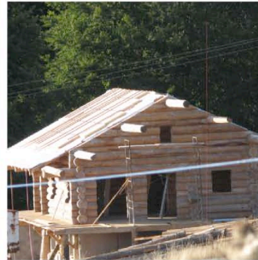
Lacombe : murs en rondins de bois pour cette maison en cours de chantier
