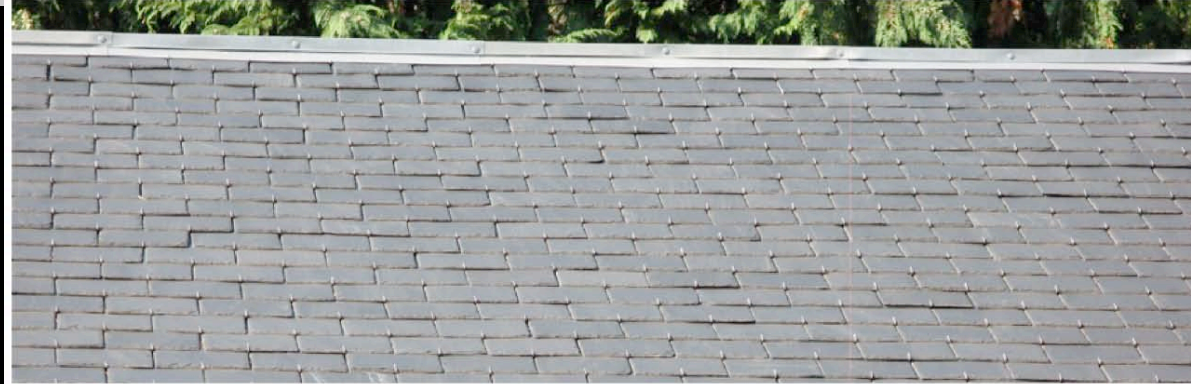
Cuxac Cabardés l'ardoise régulière posée au crochet, conduit ici à traiter le faitage de l'édifice avec de la zinguerie.
