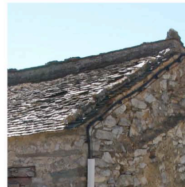
Trassanel couverture d'une bergerie dans le village, les façons de faitage diffèrent selon les cas.
