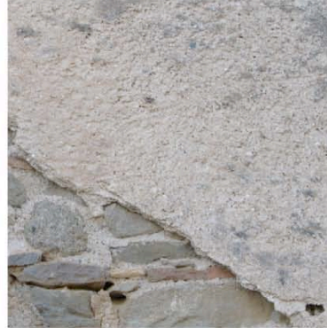
Bouilhonnac : parfois les différentes couches d'enduits se détachent des maçonneries de pierre qu'elles protègent
