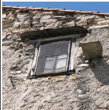
Cabrespine fenêtre de grenier avec détail de protection du cadre bois par une lauze et pierre de repos pour les pigeons
