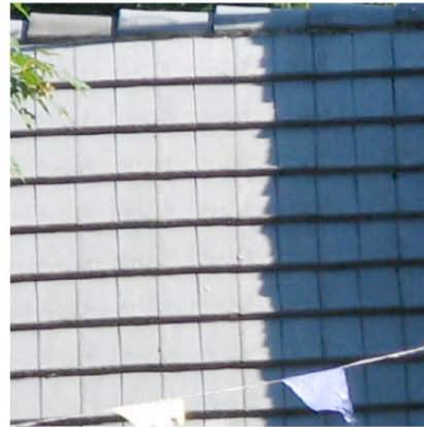
Pradelles Cabardés modules de tuiles béton plates noires
