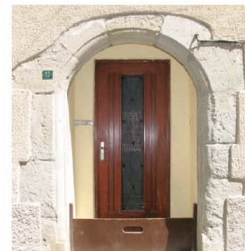
Rieux Minervois : mise en retrait et reconstitution d'ouverture de porte derrière cet encadrement daté du XVI e siècle.
