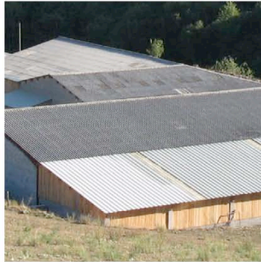
Roquefère tôle ondulée en fibro ciment ondulé pour ce bâtiment d'élevage
