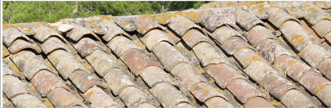
Bouilhonnac : le format des tuiles canal, leur pose, la charpente, permettent d'absorber dans le temps quelques déformations.
