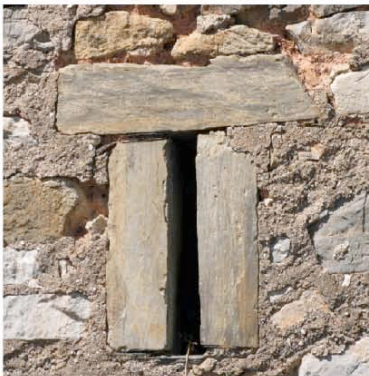
Trassanel : ventilation pour une grange
