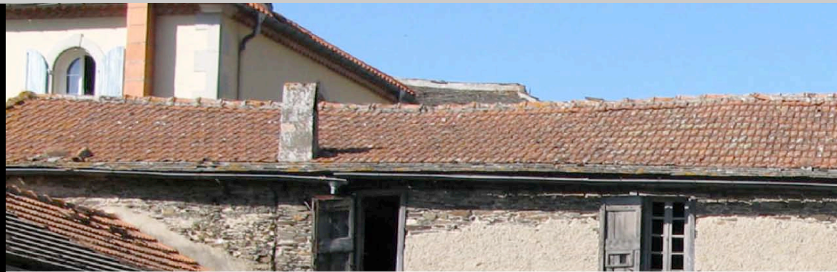
Caudebronde la tuile mécanique plate dite de Marseille s'adapte aux pentes des versants couverts de tuiles canal ou de lauze, qu'elle a pu remplacer.
