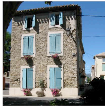
Azille maison à la façade «décroutée»
