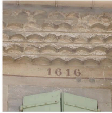
Douzens réenduite, mais exceptionnelle par le nombre de rangs, à noter le badigeon qui la couvre et le décor de couronnement avec date.
