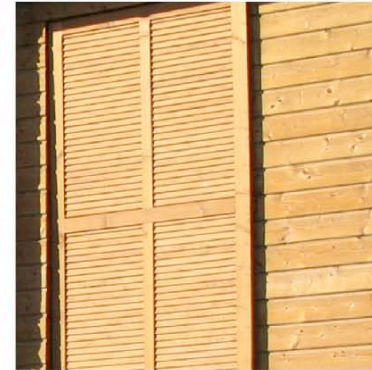
Ventenac : traitement des murs extérieurs et des menuiseries en bois pour ces logements contemporains
