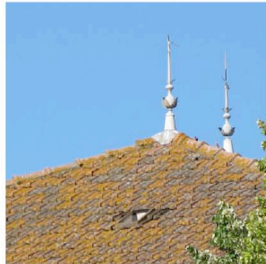
Marseillette épi de faitage en zinc et toiture en tuiles mécaniques de terre cuite
